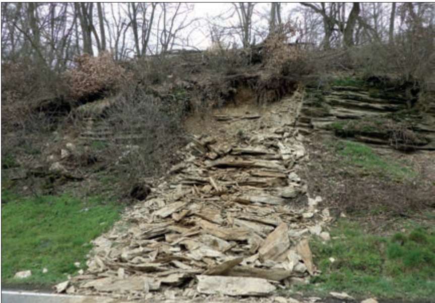
Abb. 3: Kleiner Felssturz an der L 3031 zwischen Beuerbach (Gemeinde Hünstetten; Rheingau-Taunus-Kreis) und Bad Camberg (Landkreis Limburg-Weilburg) in unterdevonischen Ton-schiefern im März 2022; Foto: HLNUG.
