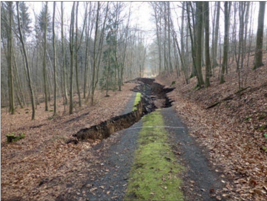
Abbildung 2.: Abrissbreich der Rutschung im Berstädter Markwald (Gemeinde Wölfersheim, Wetteraukreis), der einen Waldweg zerstörte; Foto: HLNUG.
